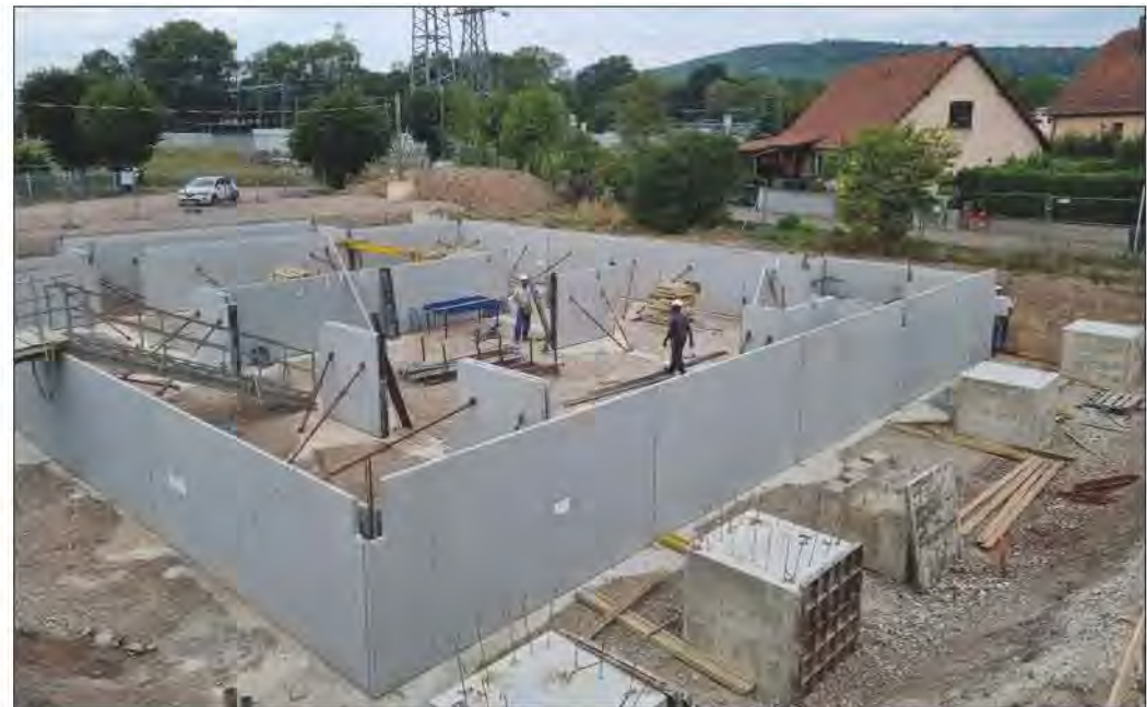
Les pans du soubassement de la future cantine sont déjà en place. Les équipes en charge du gros œuvre travaillent dans des conditions difficiles en raison de la chaleur. Photos DNA
